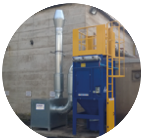
Ventilation générale et centrales de filtration
